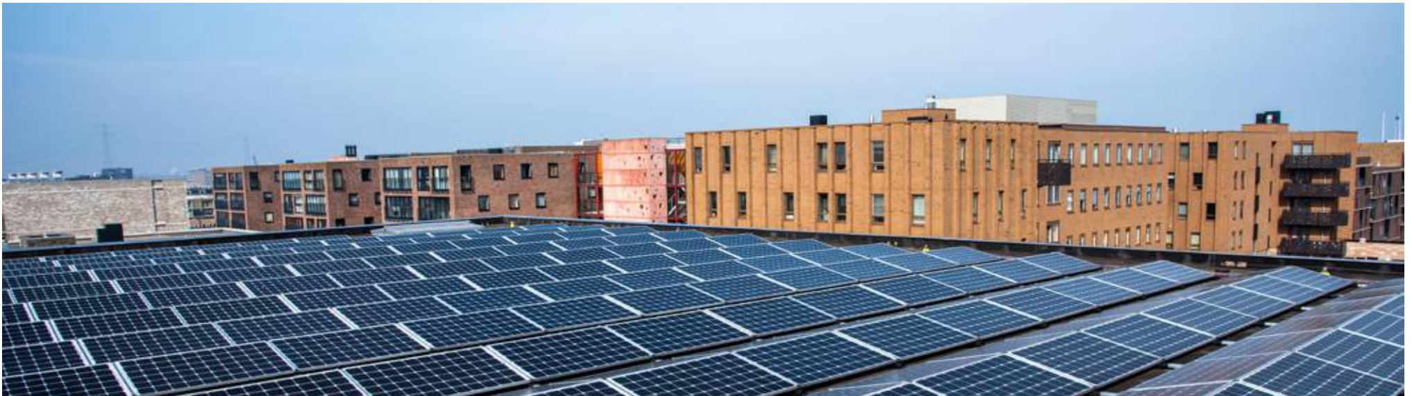
Afb. 8.5 Zonnecollectoren op dak IJburg College, Amsterdam Oost
